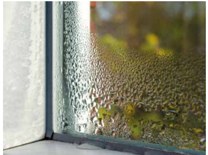
Während Türen und Fenster lange halten, werden Dichtungen weit früher spröde, härten aus oder sind mechanisch zerstört. (Foto: djd/GfA-Dichtungen/Getty Images/nadisja)
